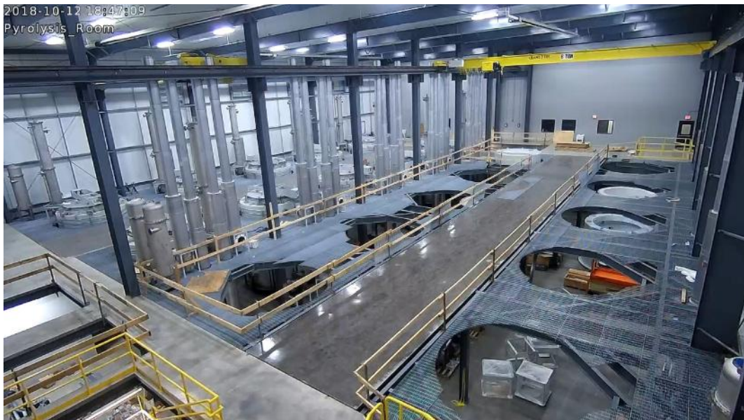
Pyrolyseraum der Fabrik in Indiana
